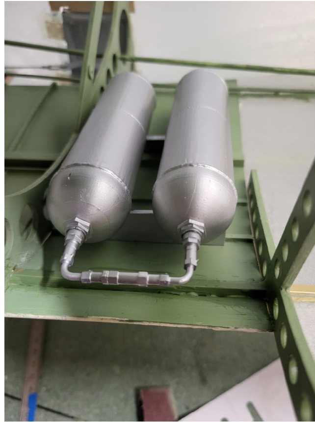
Bouteilles d'air comprimé fait en impression 3D, également installé derrière le siège du pilote.
